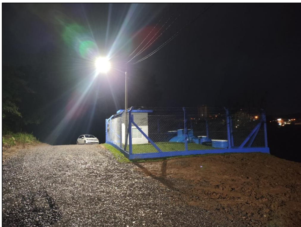
Estação de tratamento de esgoto (ETE)
