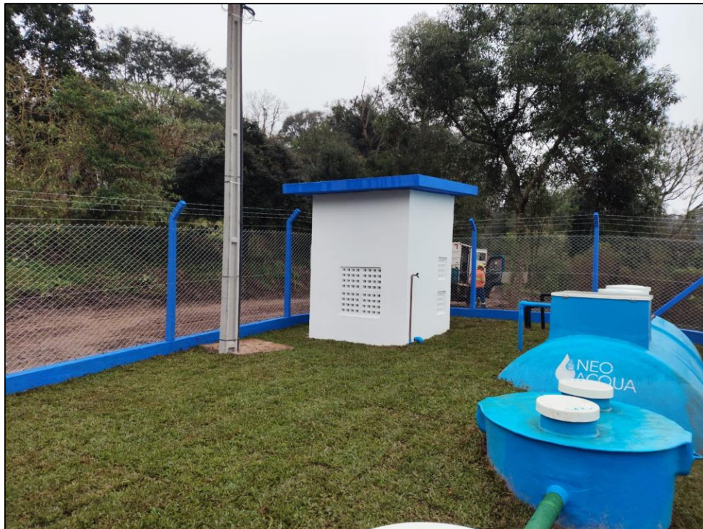
Estação de tratamento de esgoto (ETE)
