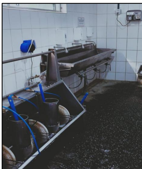
Figura 3 - Barreira sanitária utilizada para higienização das mãos e botas antes do acesso às áreas produtivas.
