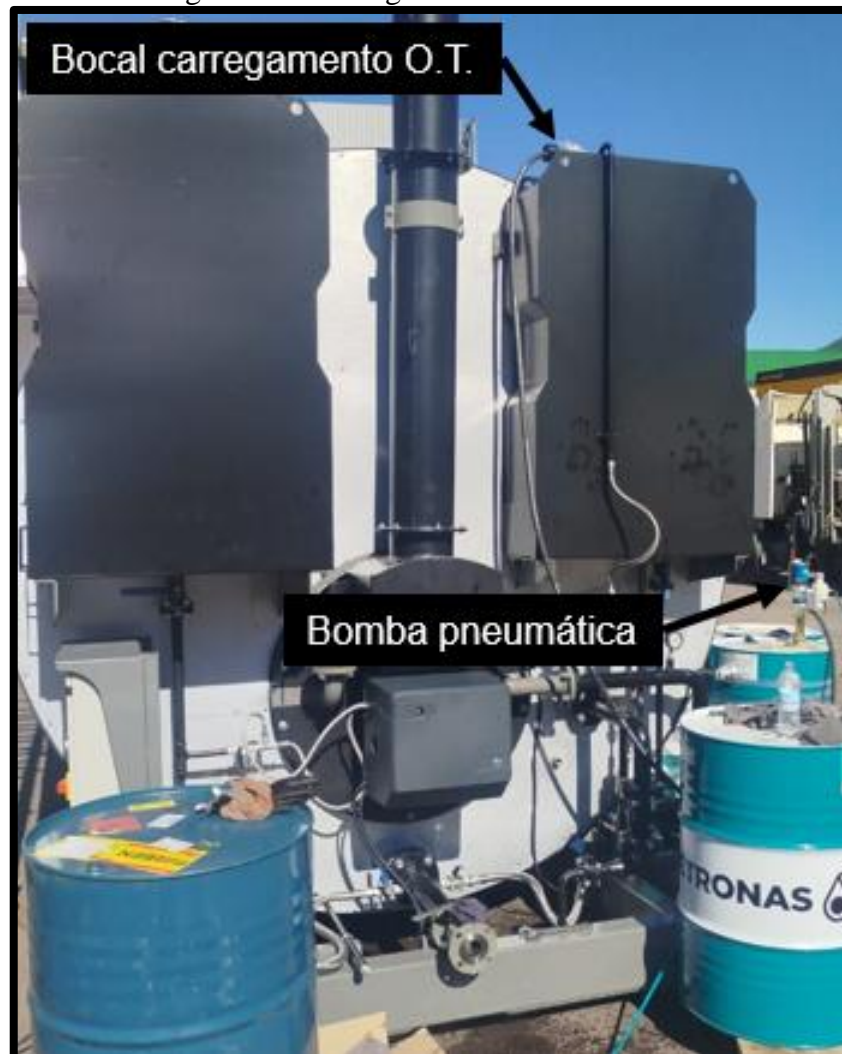
Figura 20 – Carregamento do óleo térmico
