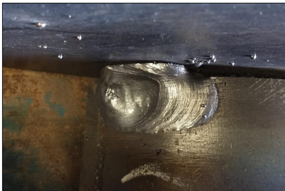
Figura 37 – Rompimento da fusão do cordão de solda inferior.
