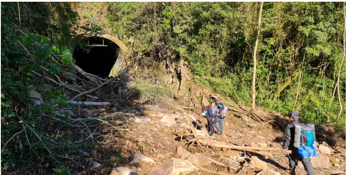
Figura 15 - Túnel da Ferrovia do Trigo soterrado por deslizamento de terras
