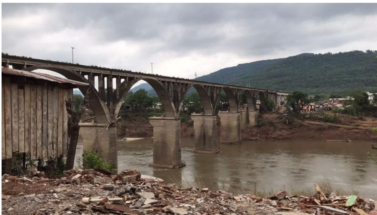
Figura 5 - Ponte Brochado da Rocha, após a inundação de setembro de 2024
