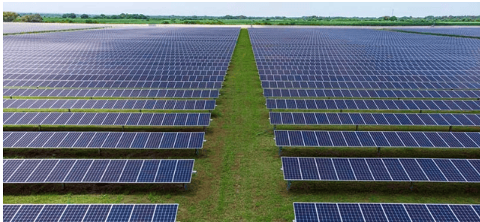
Figura 5 – Disposição dos módulos em uma usina solar de grande porte
