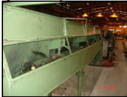
Figura 47 - Tanque de resfriamento
