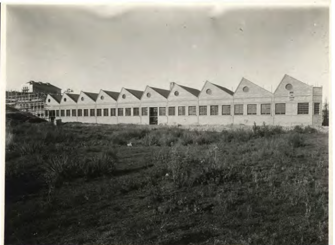
Vista lateral do Pavilhão em construção da MAESA - Fábrica 2, de frente para a rua Pedro Tomazi. Acervo: Arquivo Histórico Municipal João Spadari Adami.
