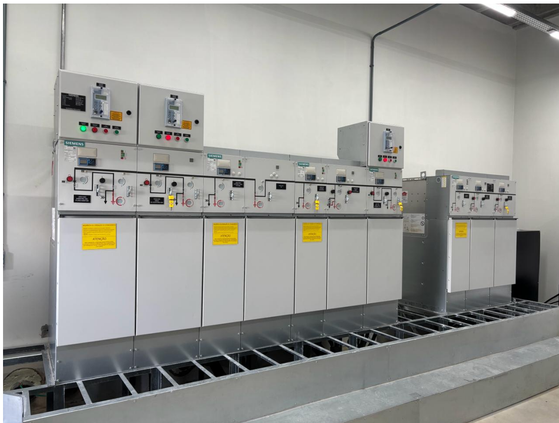
Figura 14 – Vista dos cubículos isolados a SF6 da subestação
