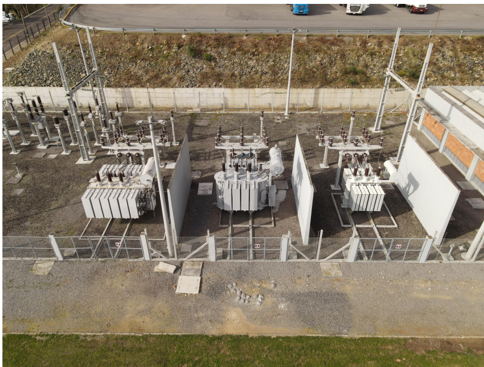
Figura 3 – Subestação 69 kV Tramontina.
