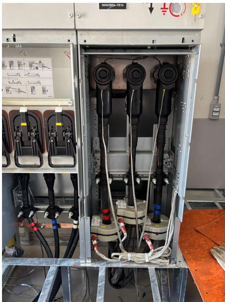
Figura 16 – Terminais desconectáveis Siemens
