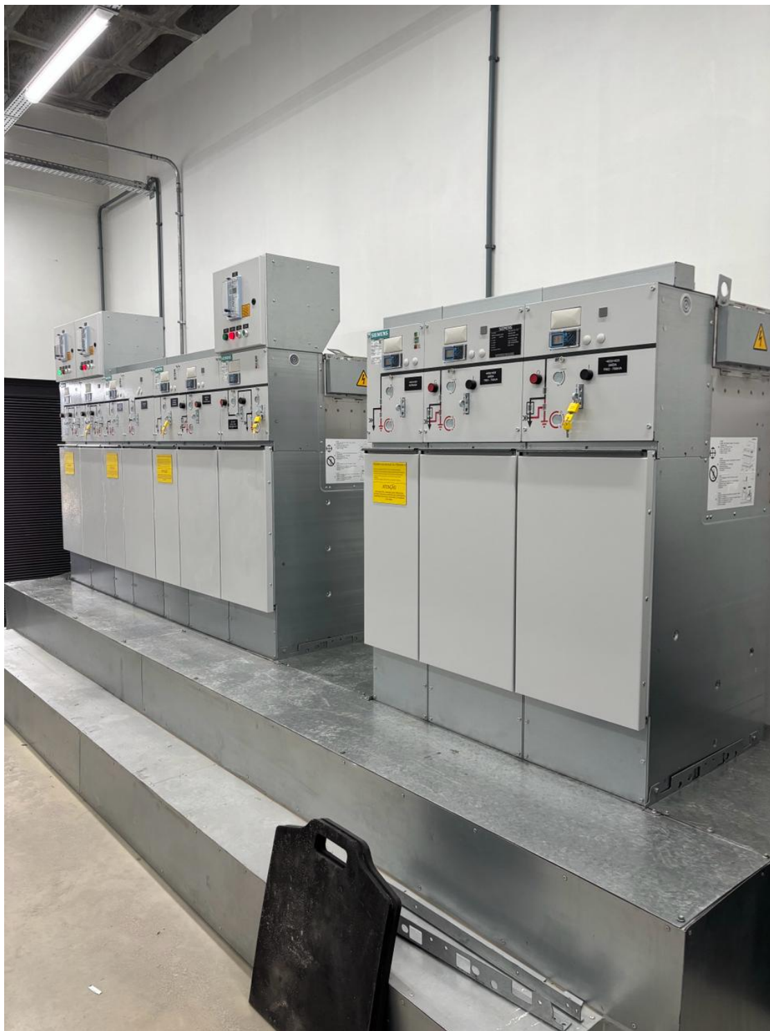
Figura 15 – Vista de outro ângulo dos cubículos SF6
