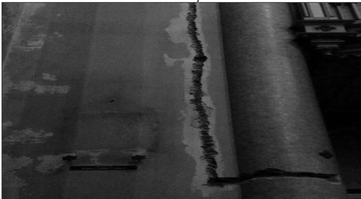
Figura 19 - Rachaduras na estrutura da Catedral Nossa Senhora da Oliveira durante a restauração
