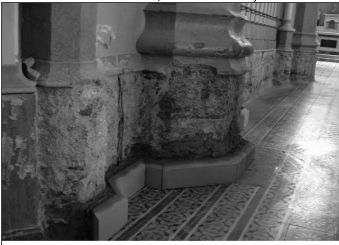
Figura 21- Intervenções estruturais na parede da Catedral Nossa Senhora da Oliveira durante o processo de restauração
