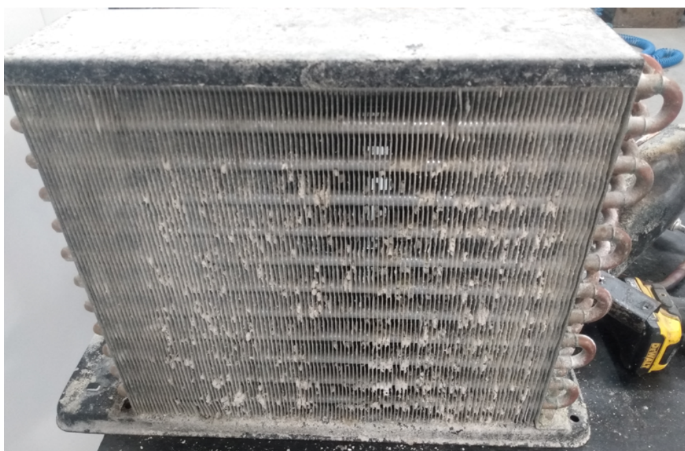
Figura 16 – Acúmulo de sujeira no condensador
