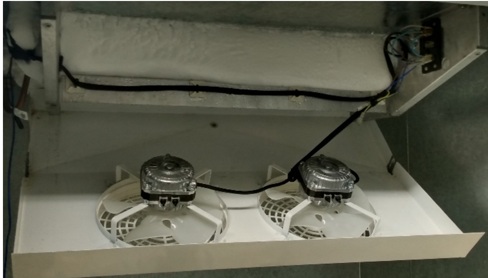
Figura 15 – Formação excessiva de gelo no evaporador
