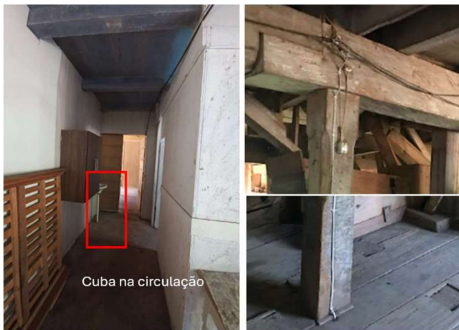
Figura 91 - Circulação e pilares com fiação de luz
