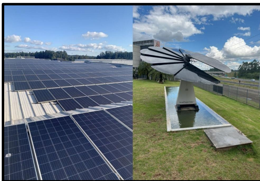
Figura 13 - Placas solares instaladas na empresa Run More
