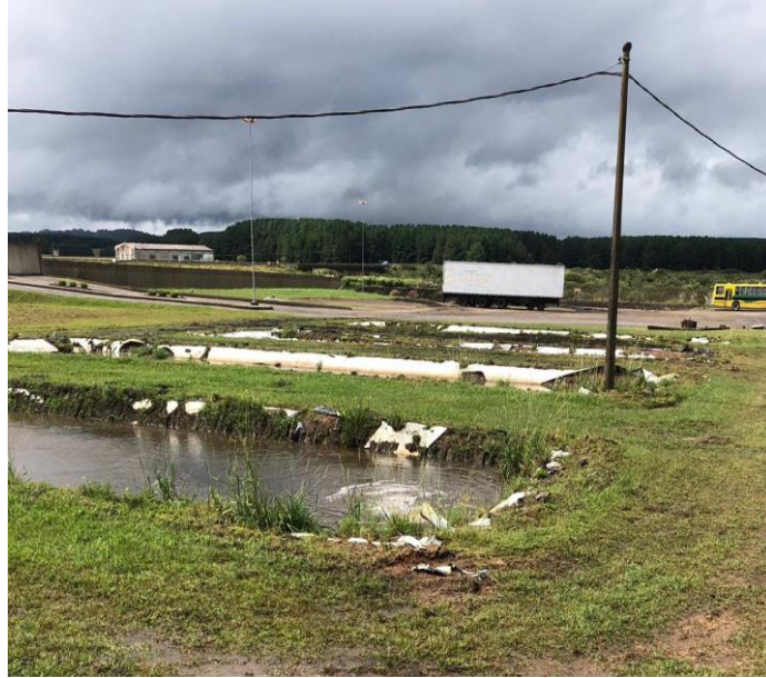
Figura 29 - Sistema de Estação de Tratamento de Efluente (ETE)
