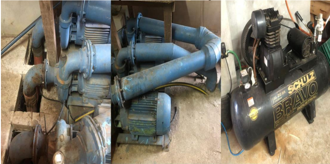
Figura 27 – Bomba de Água
