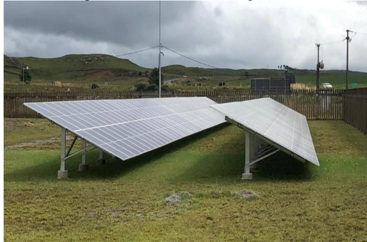
Figura 35 – Placas de Energia Solar
