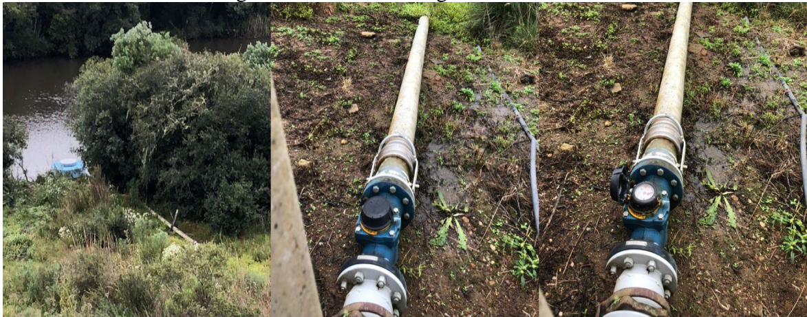
Figura 24 – Bomba de Água e Hidrômetro
