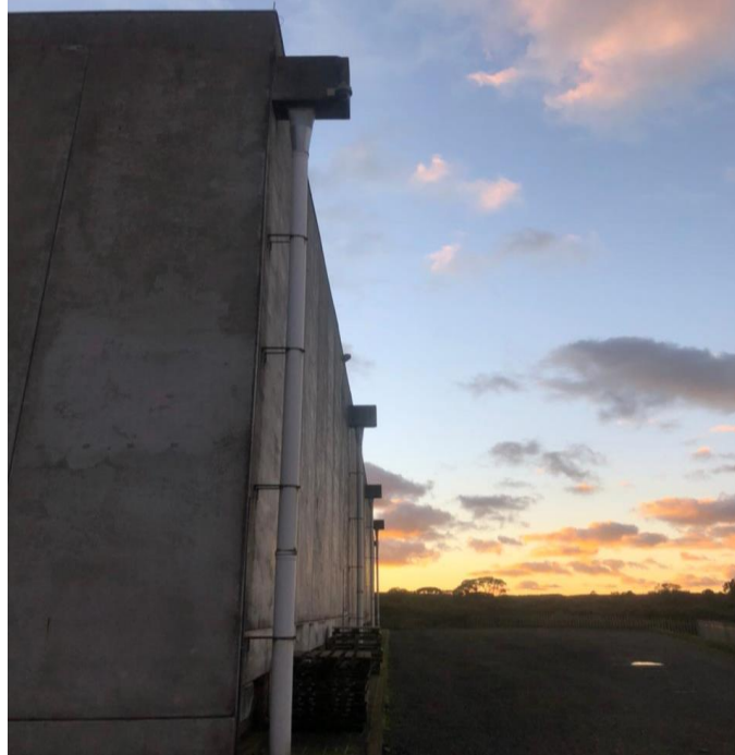
Figura 25 – Captação da Água da Chuva
