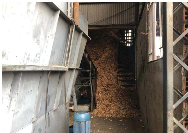
Figura 28 – A CALDEIRA SENDO ABASTECIDA COM OS REFUGOS DE MADEIRA
