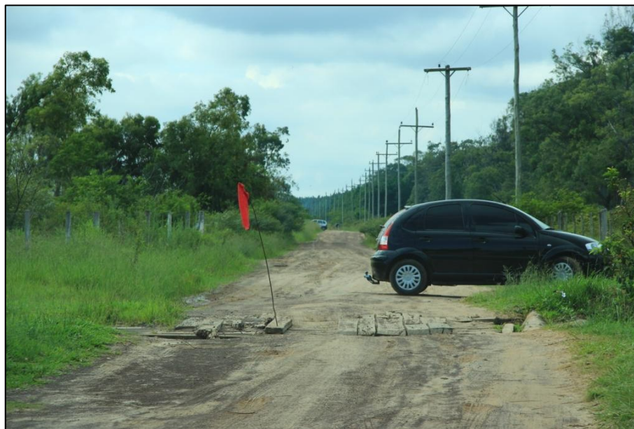
Figura 21 – Ponte em péssimo estado de conservação na Estrada Júlio Brunelli (Santo Antônio da Patrulha – RS) é sinalizada para aviso aos motoristas, margem sudoeste da Lagoa dos Barros
