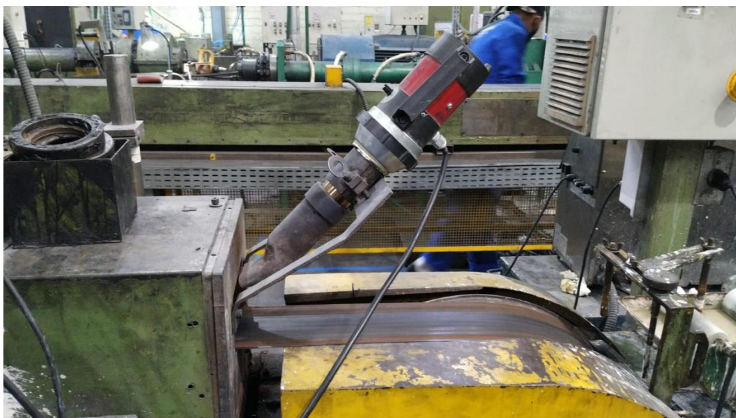
Figura 28 – Soprador de ar quente instalado
