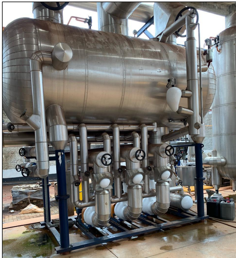
Figura 5 – Reservatório de líquido e bombas
