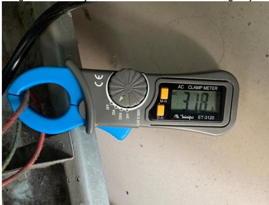
Figura 15 - Medição da corrente de motor de refrigeração
