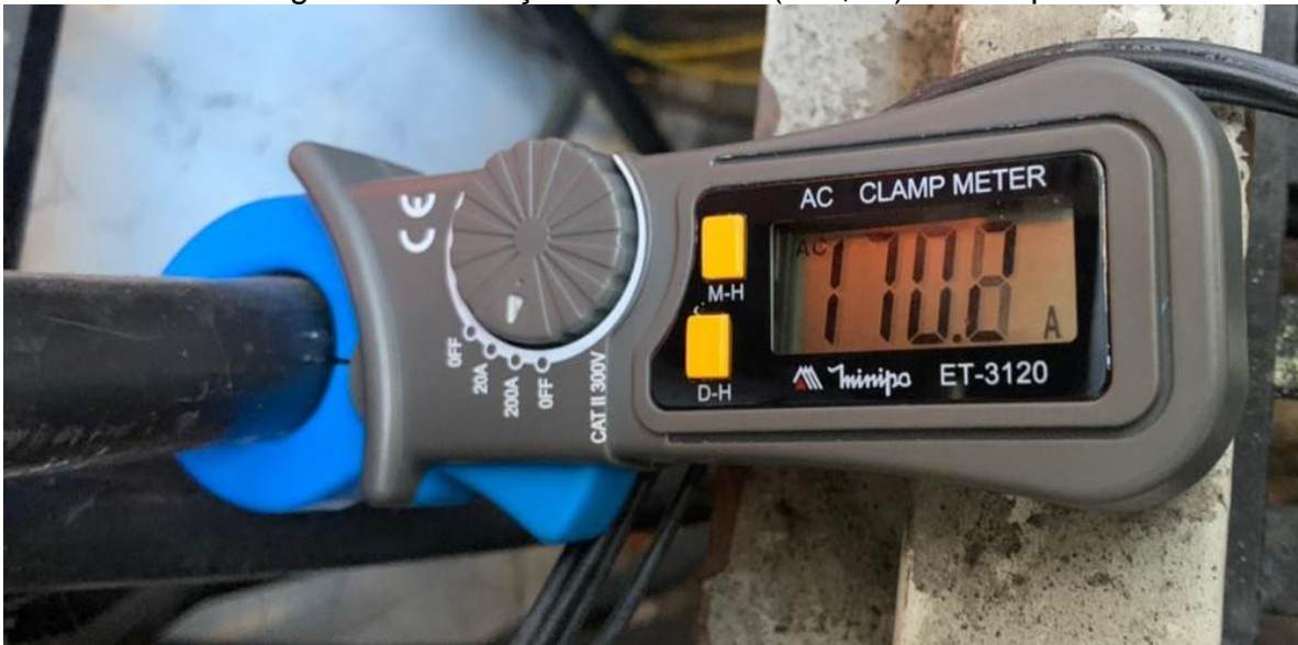
Figura 22 - Medição da corrente (170,2A) do compressor
