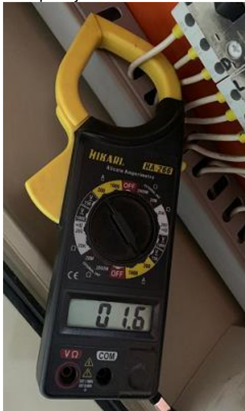
Figura 18 – Corrente de operação dos motores das bombas de combustível
