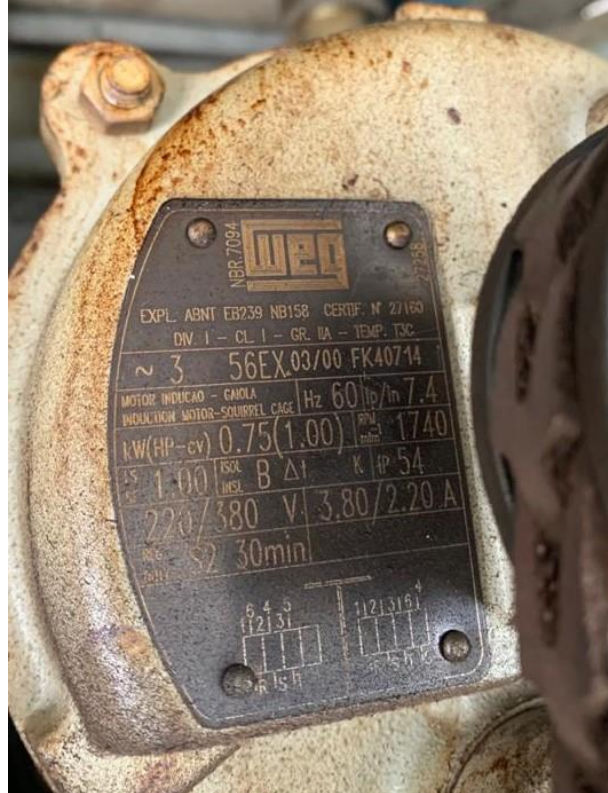
Figura 17 - Dados de placa do motor para bomba de combustível
