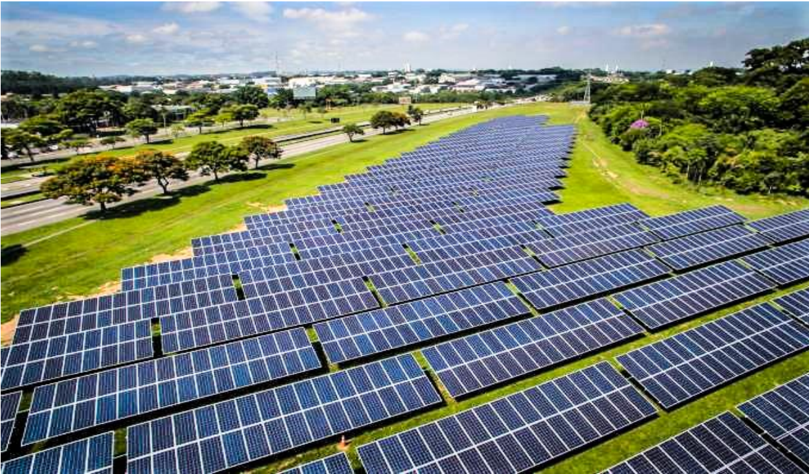
Figura 5: Usina Solar fotovoltaica
