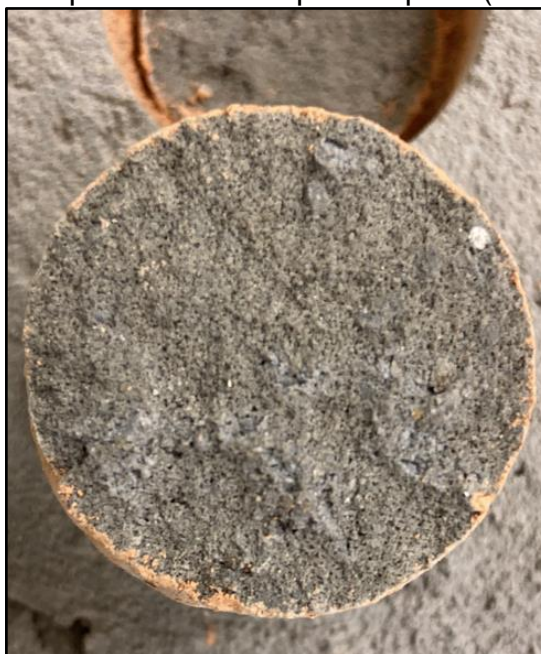
Figura 26 - Testemunho Apresentando Ruptura Tipo C (Na interface do Chapisco)
