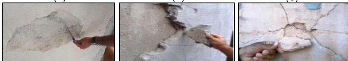
Figura 23 – Descolamento do revestimento de acordo com suas principais causas (A) (B) (C)
