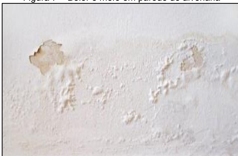
Figura 7 – Bolor e mofo em parede de alvenaria
