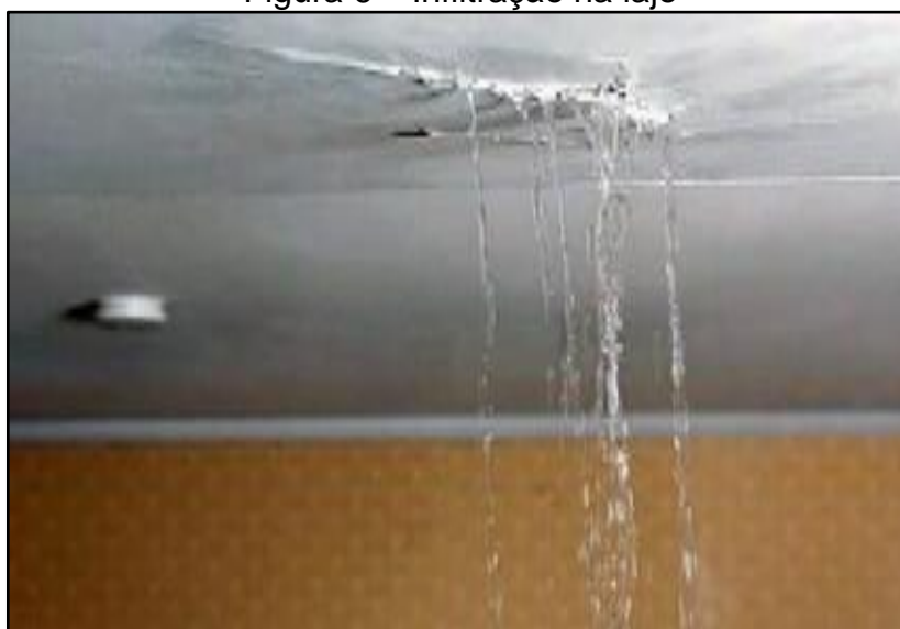
Figura 6 – Infiltração na laje
