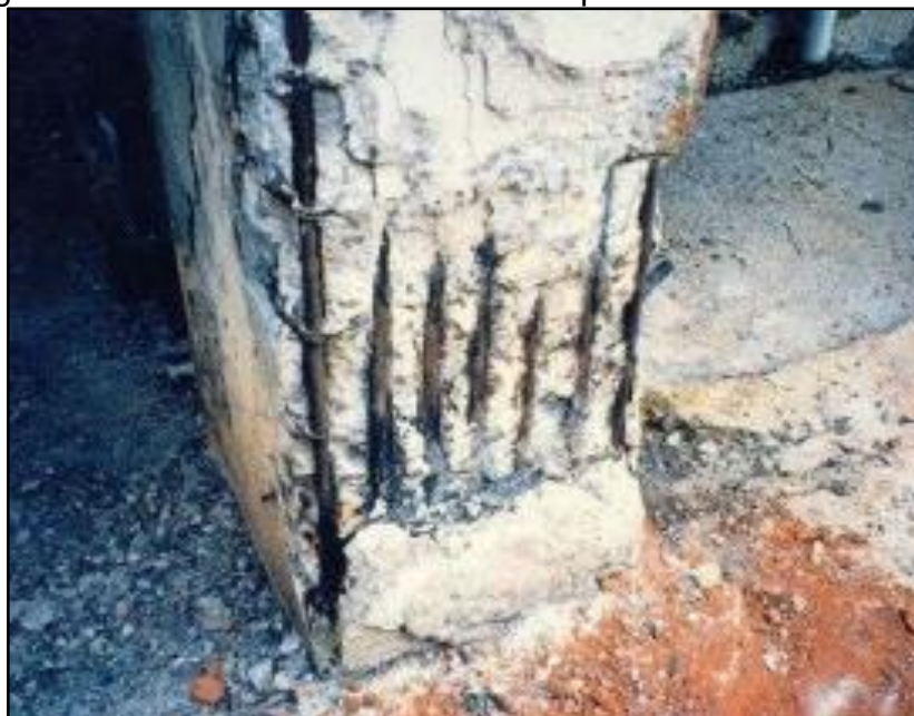
Figura 19 – Corrosão de armadura em pilar de concreto armado
