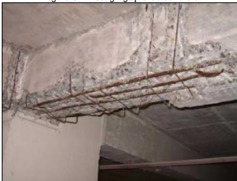
Figura 5 – Desagregação do concreto
