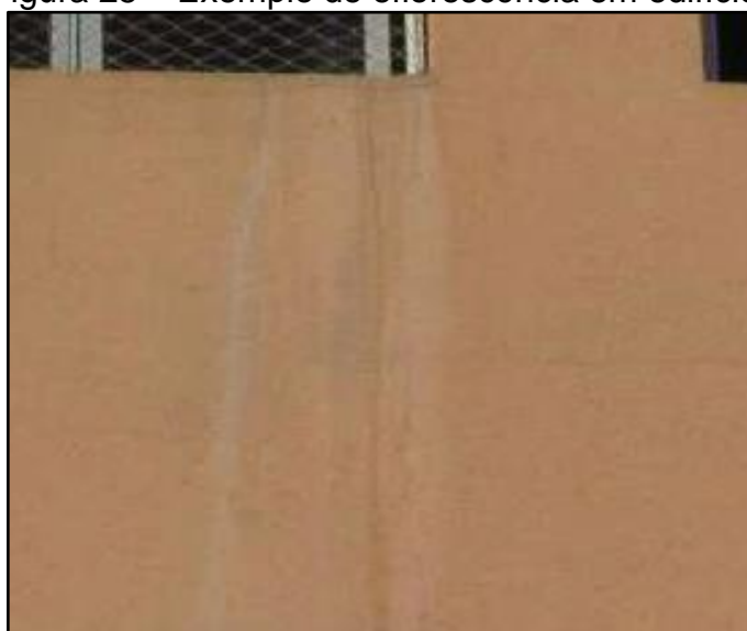
Figura 25 – Exemplo de eflorescência em edifícios
