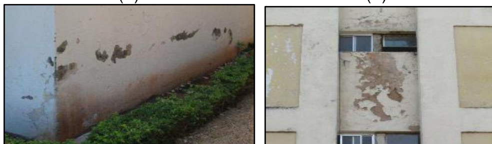
Figura 24 – Ocorrência de pulverulência em revestimento de argamassa (A) (B)
