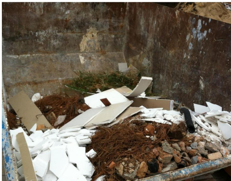
Figura 13 - Descarte inadequado de gesso acartonado
