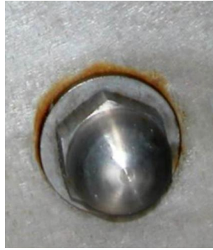
Figura 6 – Exemplo de corrosão em fresta de uma ligação parafusada
