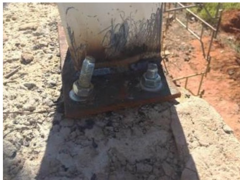
Figura 5 – Exemplo de defeito de montagem em obra
