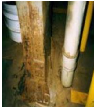
Figura 7 – Exemplo de corrosão uniforme em coluna de aço
