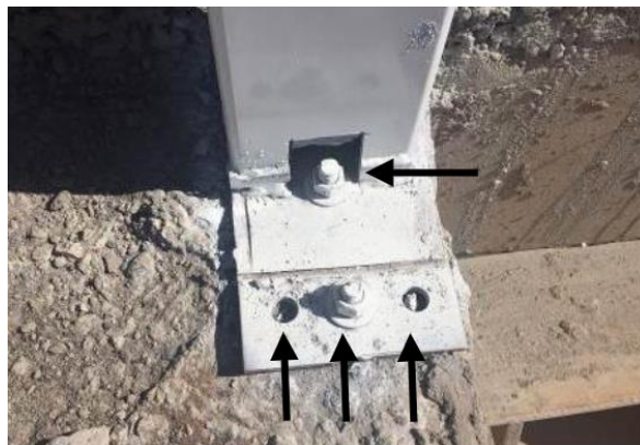
Figura 4 – Exemplo de falha de projeto em obra
