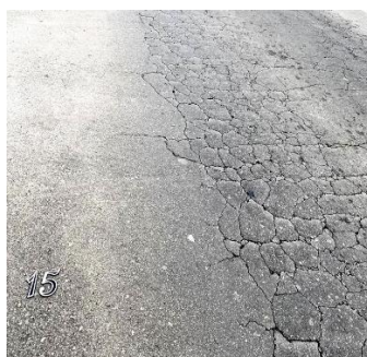
Figura 60 - Trincas interligadas tipo "bloco"
