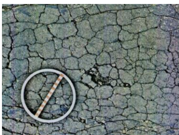
Figura 9 - Trincas tipo couro de jacaré
