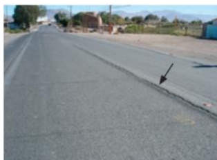
Figura 7 - Trinca de retração
