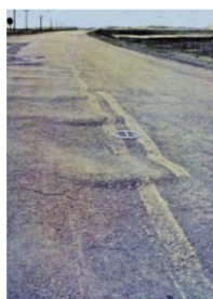
Figura 12 - Ondulação no revestimento
