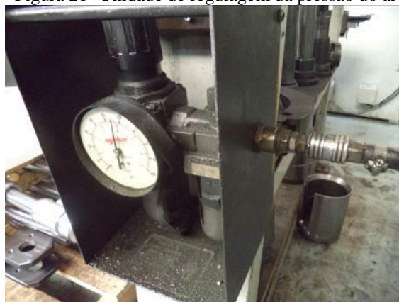
Figura 21- Unidade de regulação da pressão do ar
