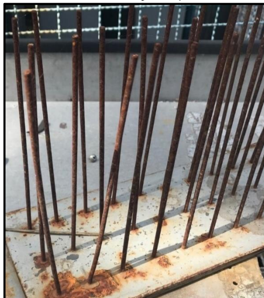
Figura 2 - Corrosão do aço exposto a intempérie
