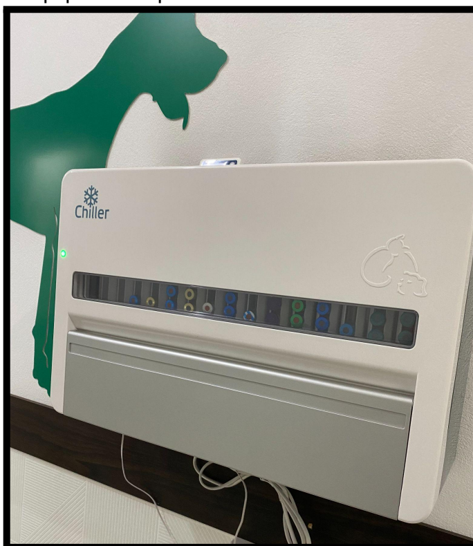
Figura 4 - Equipamento para armazenamento de vacinas ( chiller ).
