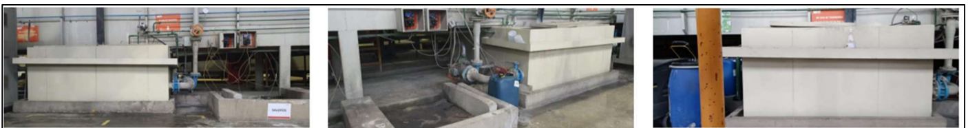
Figura 20 – Estágios 1, 2 e 3 dos tanques
