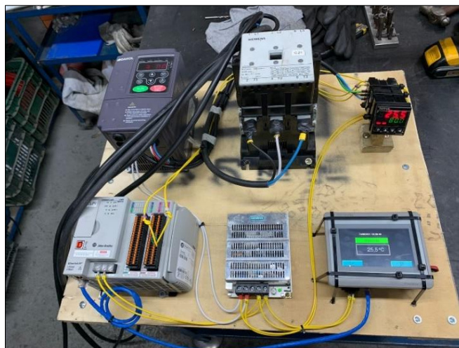
Figura 16 - Painel elétrico construído para o experimento
