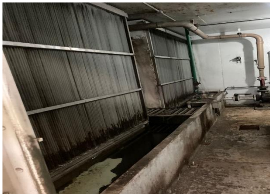
Figura 21 - Sistema de umidificação
