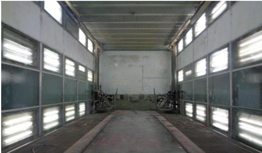
Figura 19 - Iluminação da cabine
