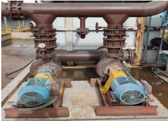
Figura 20 - Sistema de bombeamento de água
