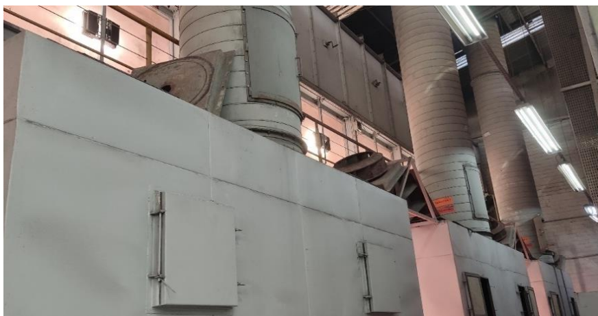
Figura 18 - Sistema de exaustão
