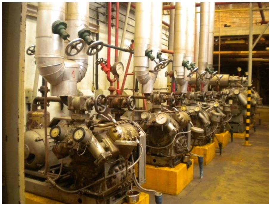
Figura13 – Compressores do sistema de refrigeração do Frigorífico Rizzo. Local: Bairro Desvio Rizzo – Caxias do Sul.
