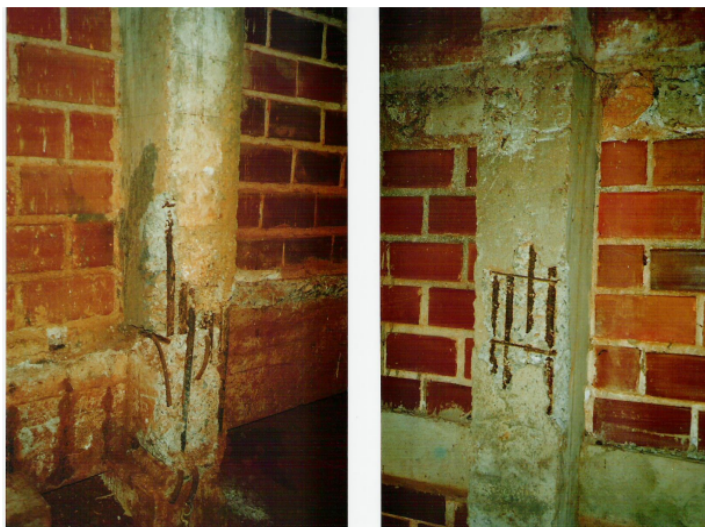
Figura 18 - Corrosão de armadura em pilar por falta de cobrimento adequado
