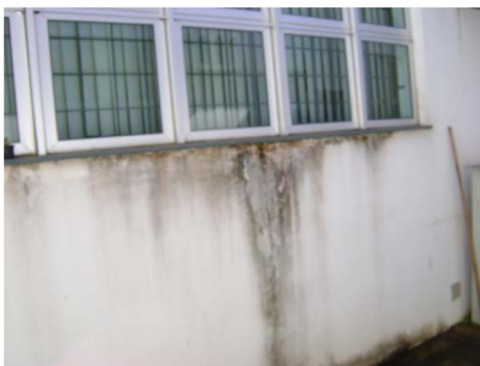
Figura 15 - Manifestação patológica causada por infiltrações - Bolor
