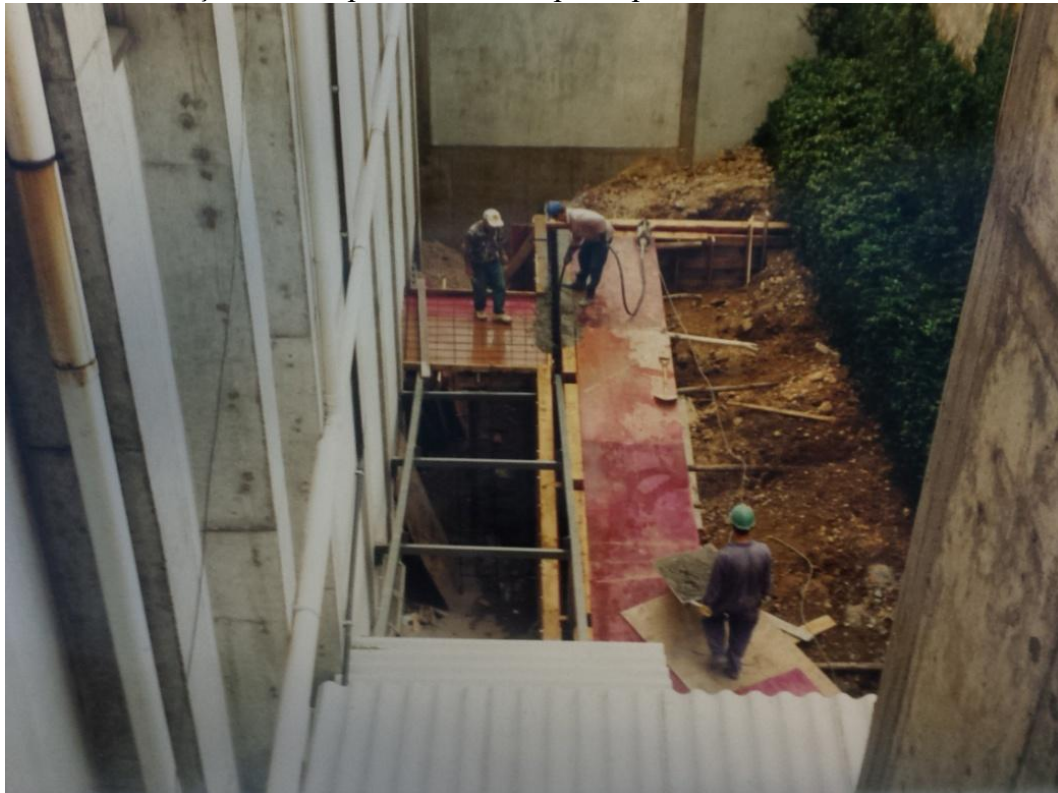
Figura 15: Reforma Teatro Municipal da Casa da Cultura . Execução da Rampa de acesso ao palco para entrada de cenários.
