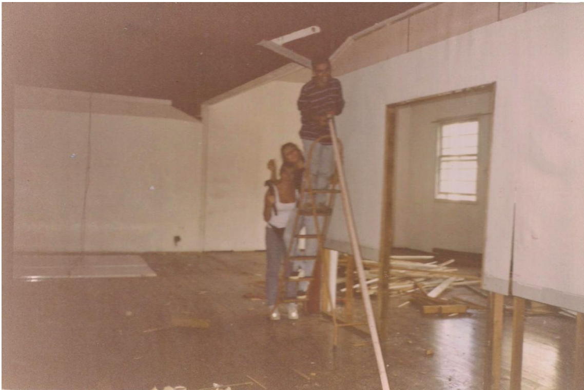
Figura 108: Início da reforma da parte interna. Visão da sala de ensaio para o fundo onde a entrada era à esquerda.
