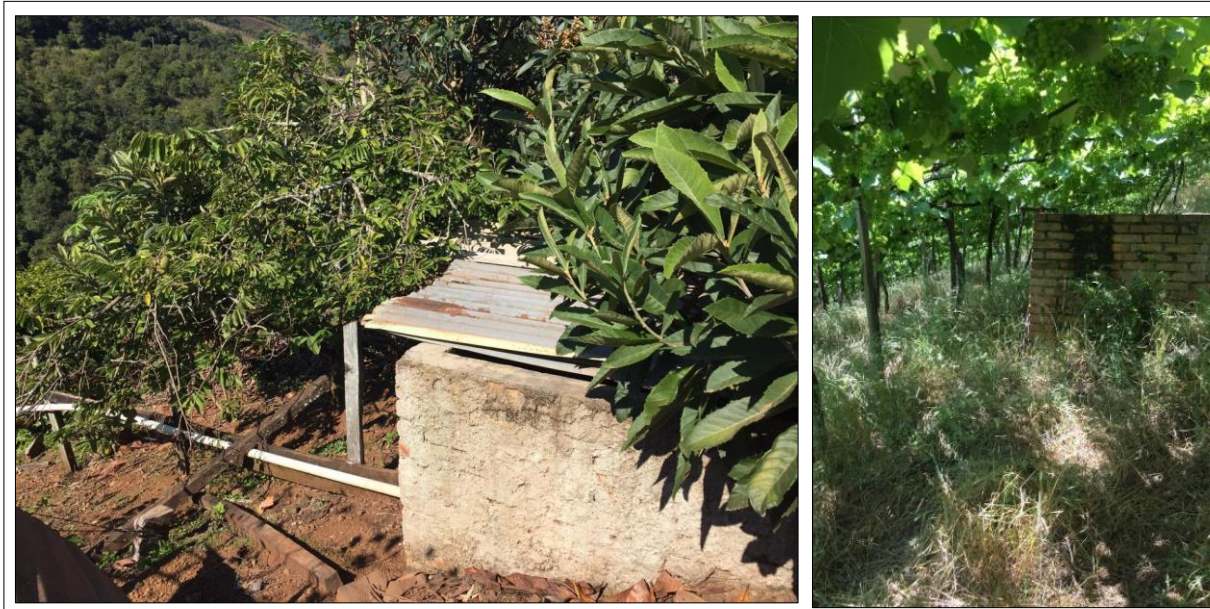
Figura 26 – Tanques de concreto inativos na propriedade
