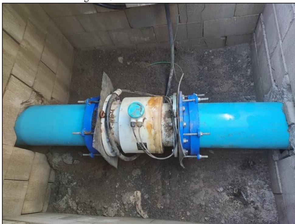
Figura 10 – Macromedidor do setor de estudo
