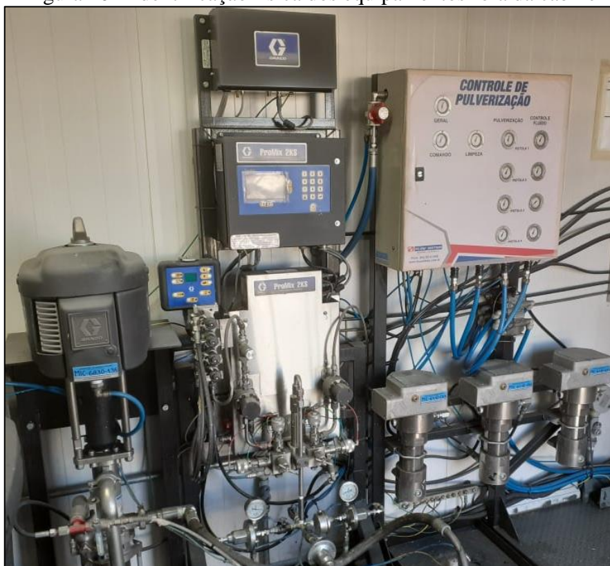
Figura 20 – Identificação física dos equipamentos fora da cabine
