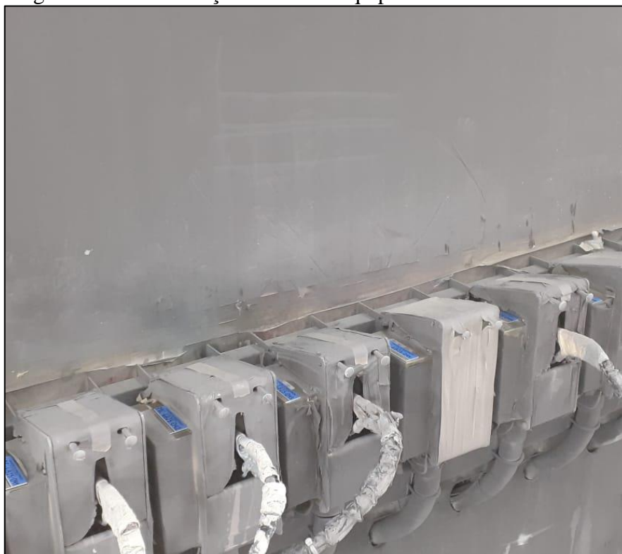
Figura 21 – Identificação física dos equipamentos dentro da cabine
