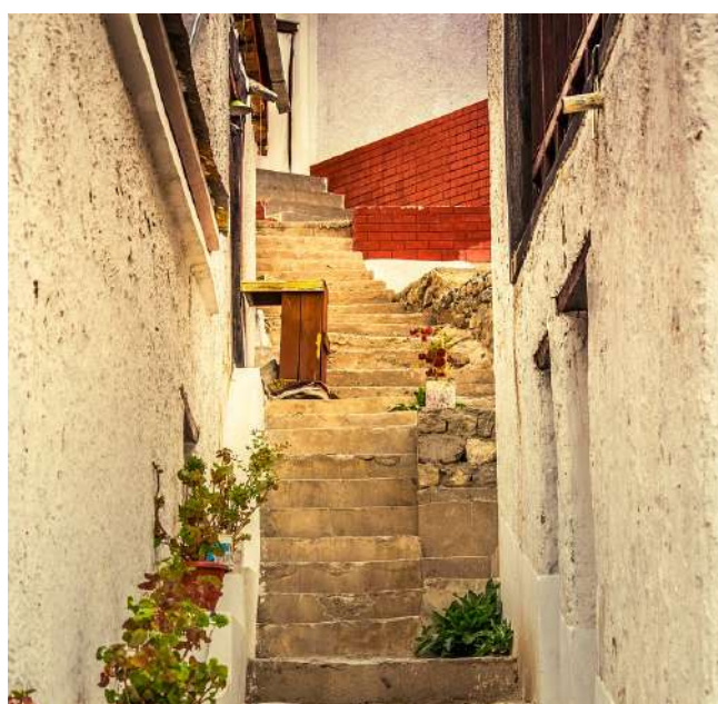
Figura 47: Escada de espelho alto e piso estreito, passa a sensação de insegurança.
