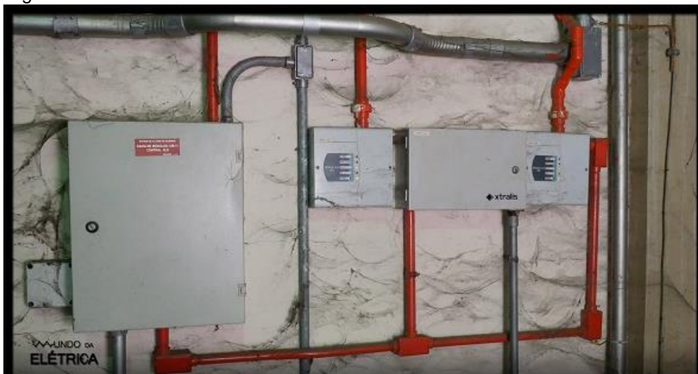
Figura 5 – Conduletes em ambientes industriais
