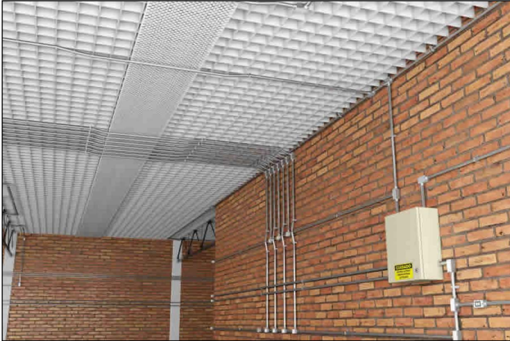
Figura 9 – Construção industrial com aplicação de condutes
