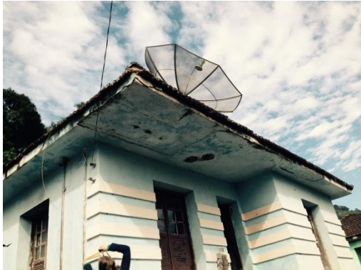
Figura 25: Registro atual 2016 – Teto estuque externo. Fonte: autora.
