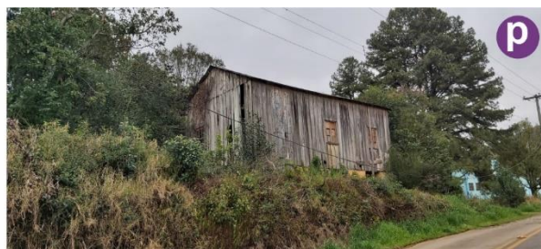
Figura 42: Casa mau estado de conservação
