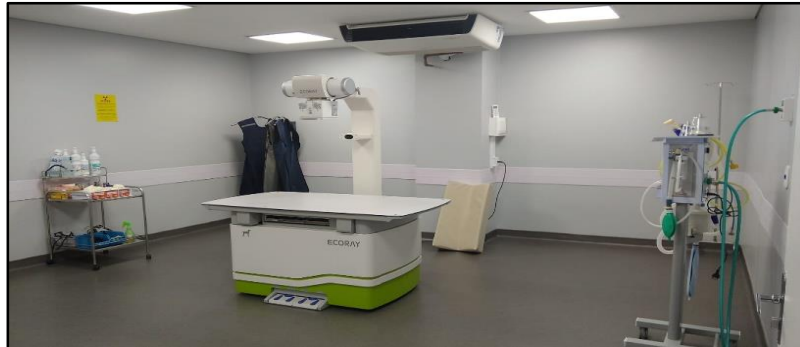
Figura 2 - Apresentação da estrutura e equipamentos da Sala de Radiologia do IHVET - UCS
