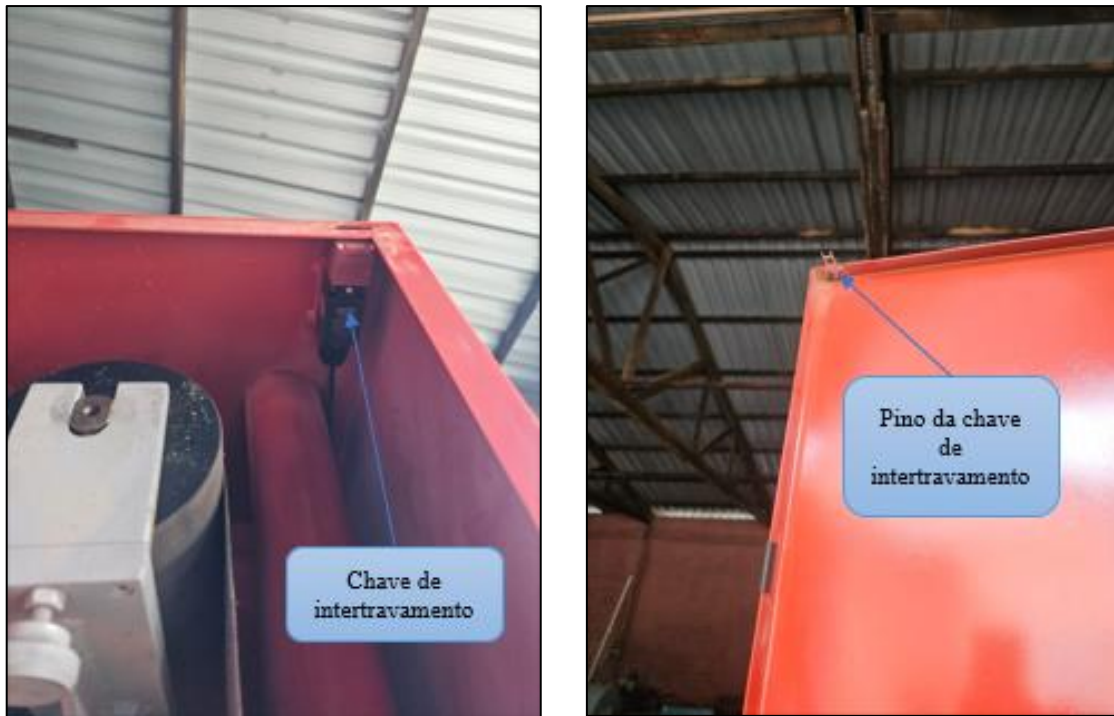
Figuras 26(a) e 26(b) – Chave de intertravamento da porta frontal do equipamento.
