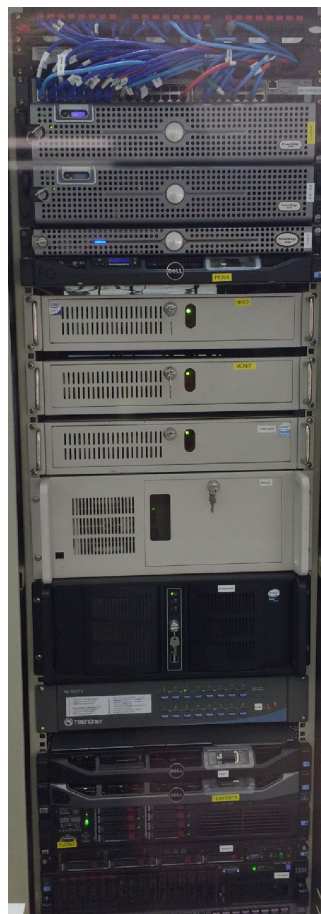
Figura 4.3: Imagem do rack e dos servidores.
