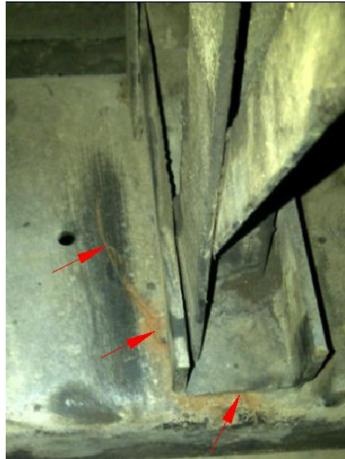
Figura 2 – Longarina do chassi com trinca iniciada na região soldada.
