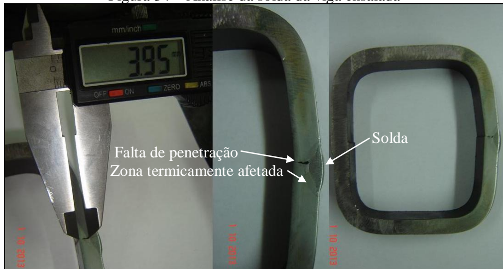
Figura 34 – Análise da solda da viga ensaiada
