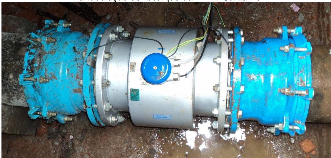
Figura 17 – Medidor de vazão eletromagnético da marca Conaut-Krohne instalado na tubulação de recalque da EBAT Santa Fé
