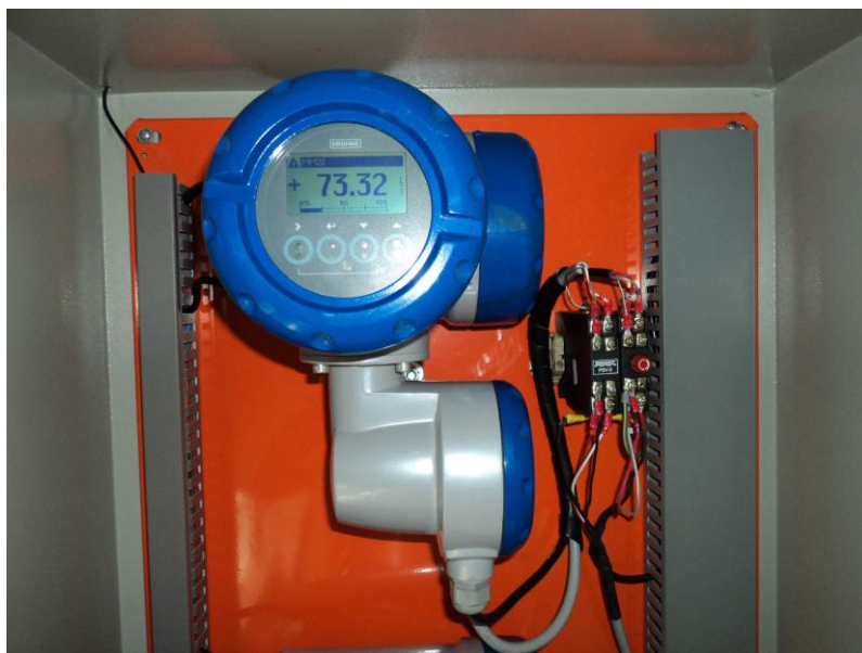
Figura 18 – Conversor de sinais do medidor de vazão eletromagnético
