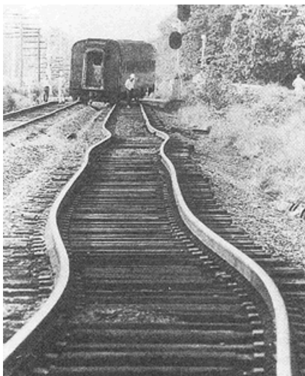
Figura 4: Fotografia de trilhos de trem distorcidos por causa da expansão térmica em um dia muito quente [22].
