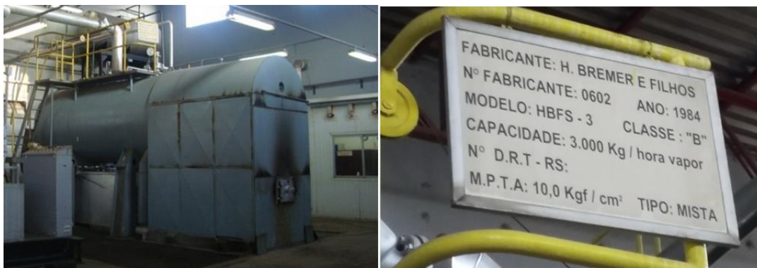
Figura 3.4 - Caldeira utilizada no frigorífico analisado
