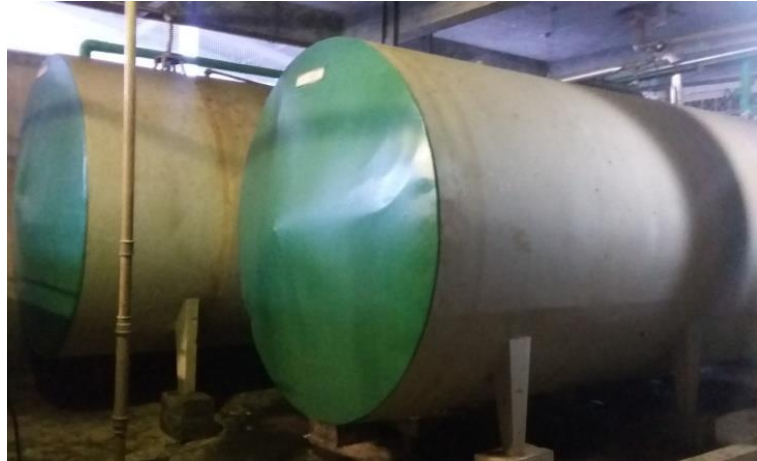
Figura 3.5 Boilers de aquecimento de água para a higienização
