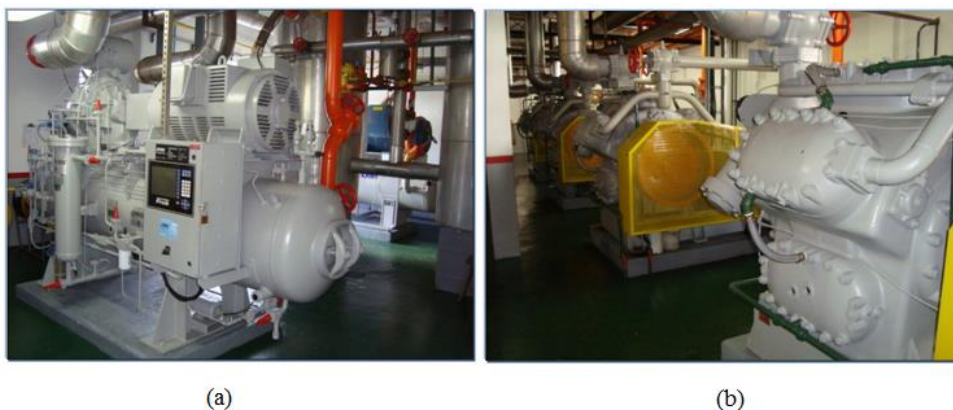
Figura 3.3 - Compressores de amônia da sala de máquinas estudada: a) parafuso; b) alternativo
