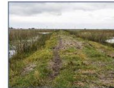
Na margem sudeste da Lagoa dos Veados foi construído um dique para o controle do nível da lagoa.
