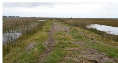
Fig 11: Na margem sudeste da Lagoa dos Veados foi construído um dique para o controle do nível da lagoa.
